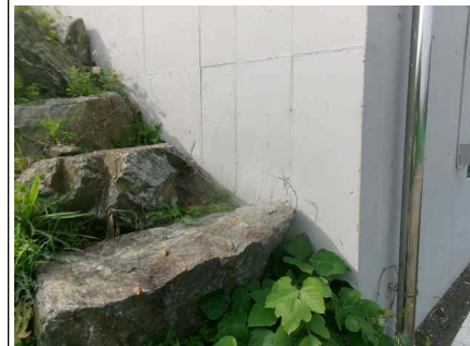
<유입밸브실 외부 벽체 파손>
