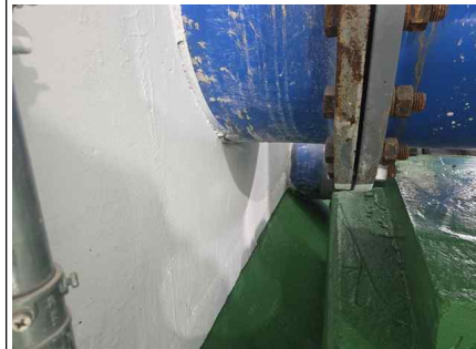
<유입밸브실 배관볼트 부식>
