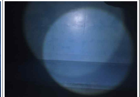
<1지 상부슬래브 백태>
