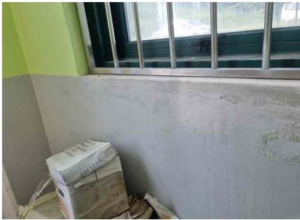
<전기실 벽체 망상균열>
