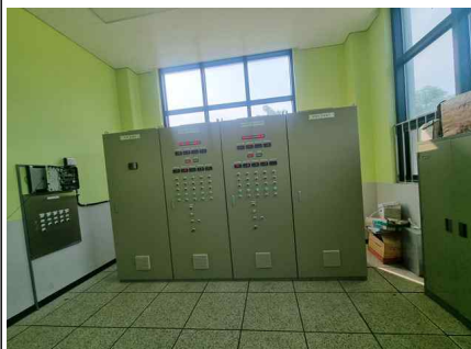
<전기실 내부 전경>
