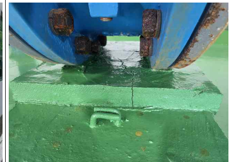
<유입밸브실 내부 설비 받침패드 균열>
