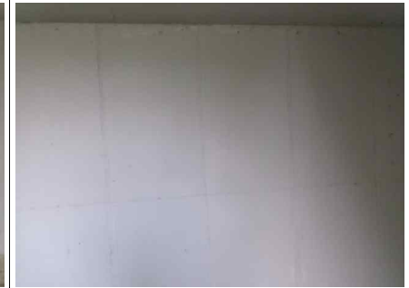
<유입밸브실 외부 벽체 균열>
