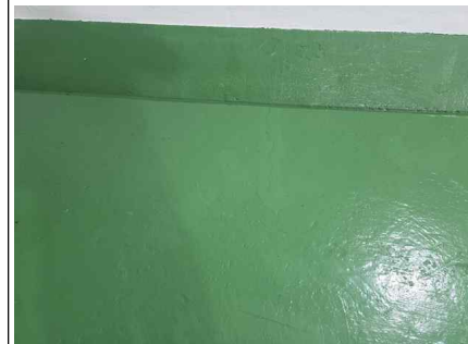
<유출밸브실 내부 바닥슬래브 균열>
