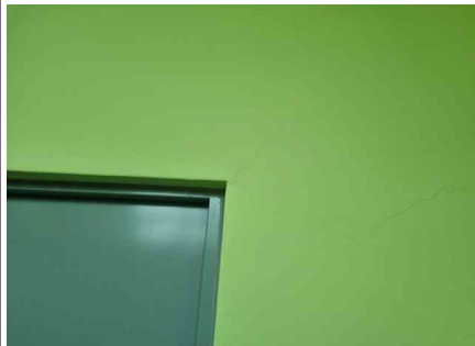
<전기실 벽체 망상균열>
