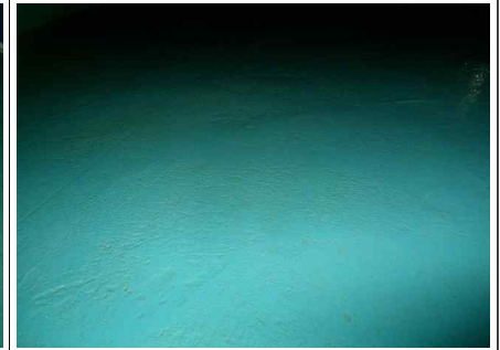
<1지 바닥슬래브 표면박리>
