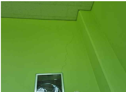
<전기실 벽체 망상균열>
